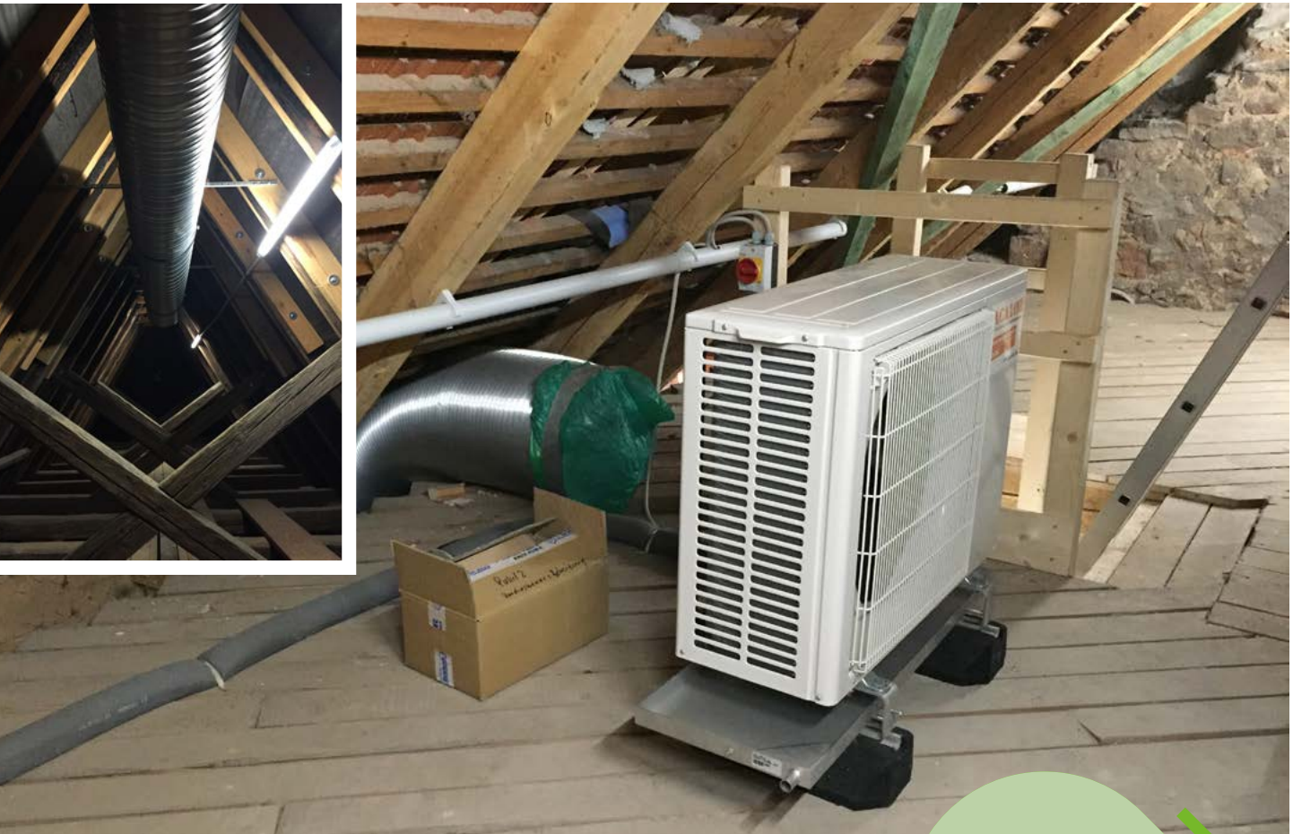
Wärmetauscher im Dach von St. Petrus in Halle (Saale)-Wörlitz: Die Wärme wird aus dem Dachraum in die Sockelzonen der Außenwände geführt, was zu einem angenehmen Raumklima des Kircheninnenraums führt.
