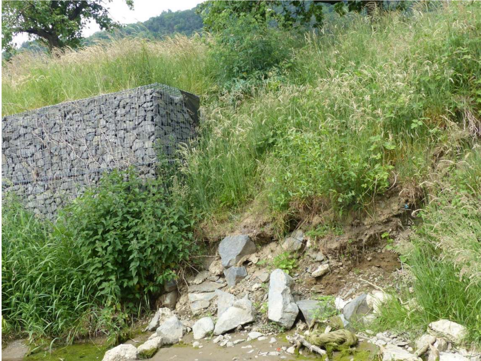
Schäden durch Erosion und Strömung an der Böschung links an Unterwasserseite
