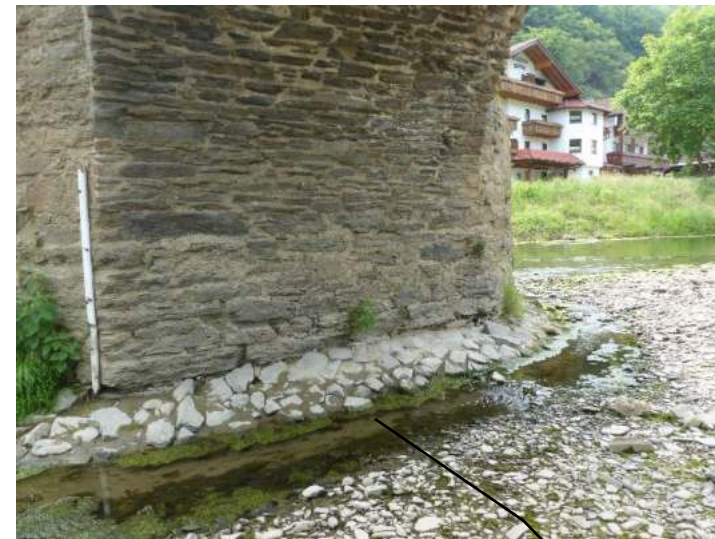
Auskolkung, Randabbruch und leichte Unterspülung Pfeilerinsel am Pfeiler West
