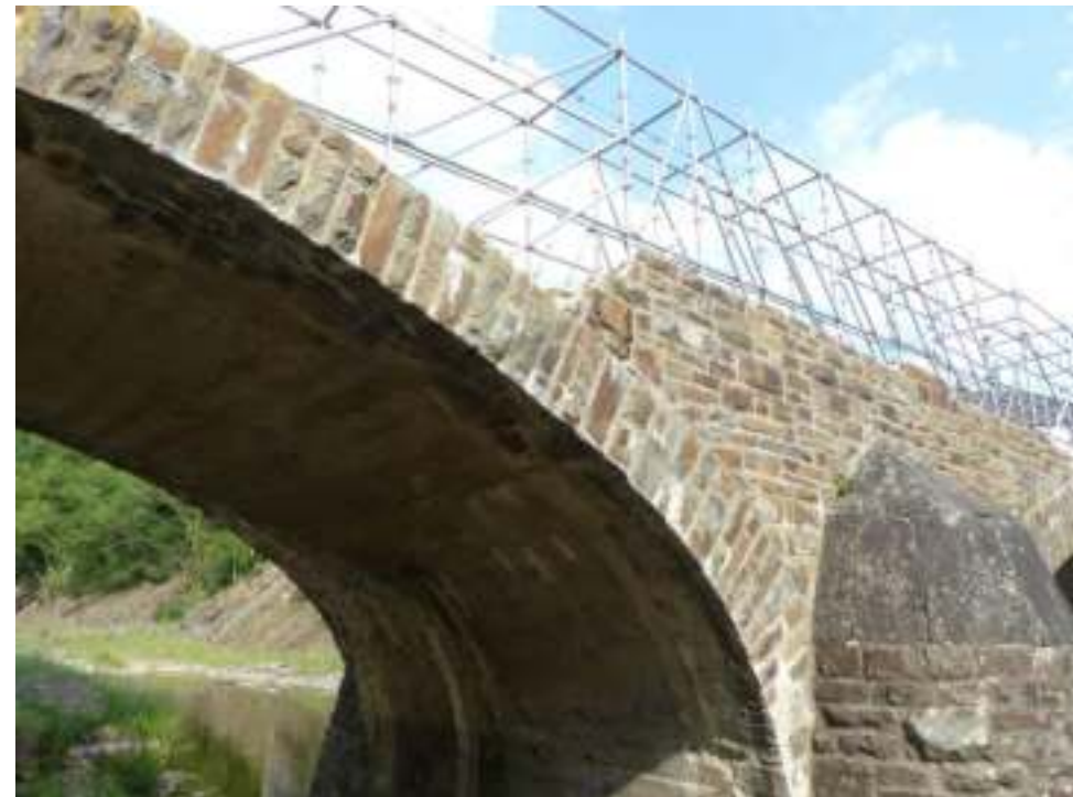
Abgerissene Brüstung und Schildmauer über dem Pfeiler 2
