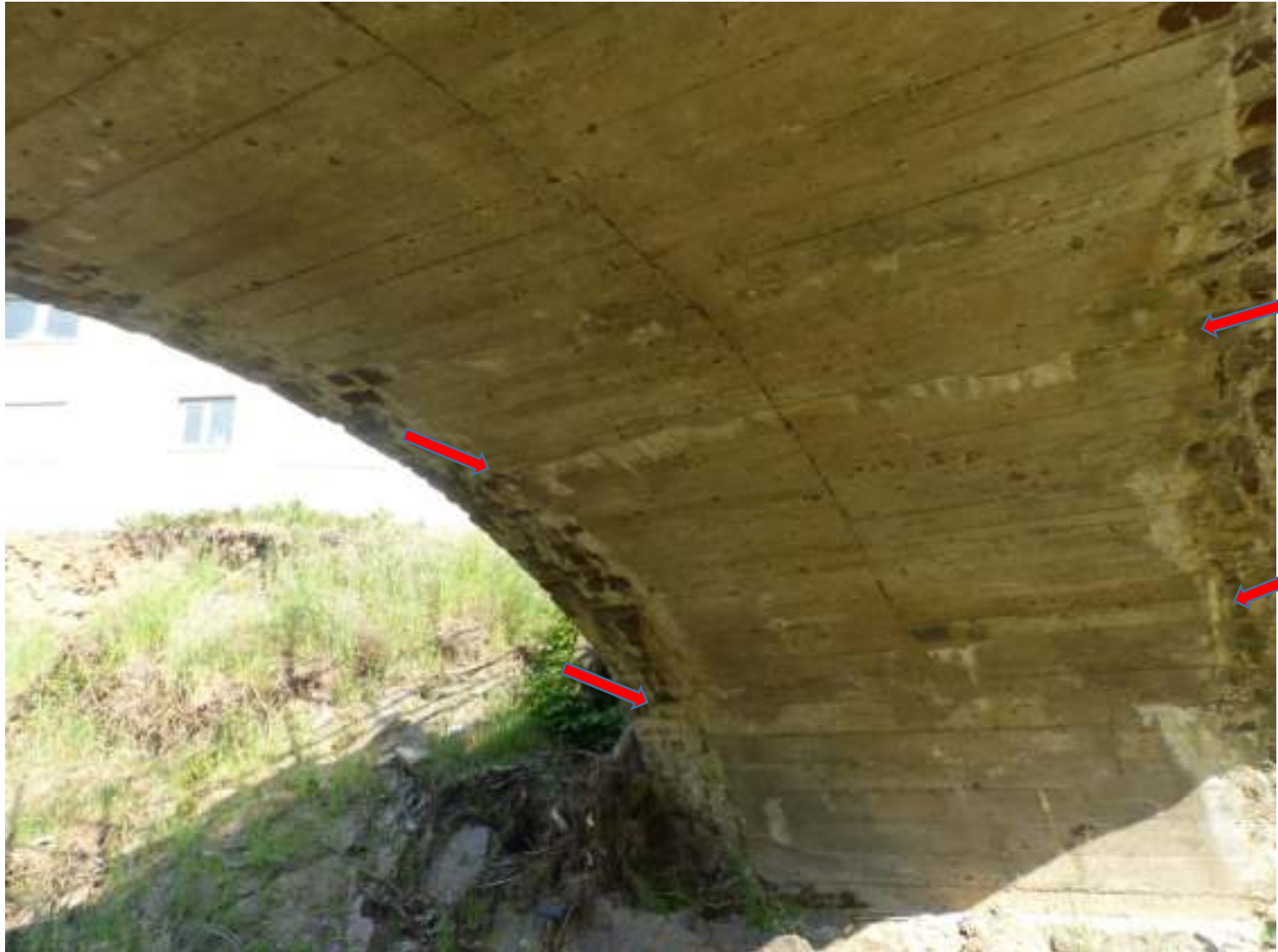
Joch 1, linkes Ufer, Haarrisse im Beton
