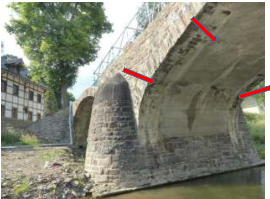
Mittlere Brückenöffnung – rechter Kämpfer, Haarriss, wasserführend
